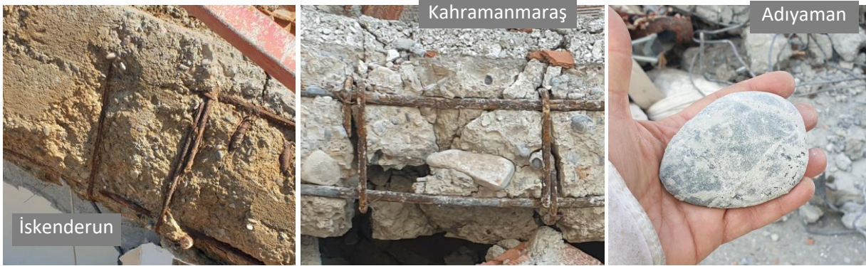
Şekil 12. Yıkılan bazı binalarda gözlenen beton kalitesi
