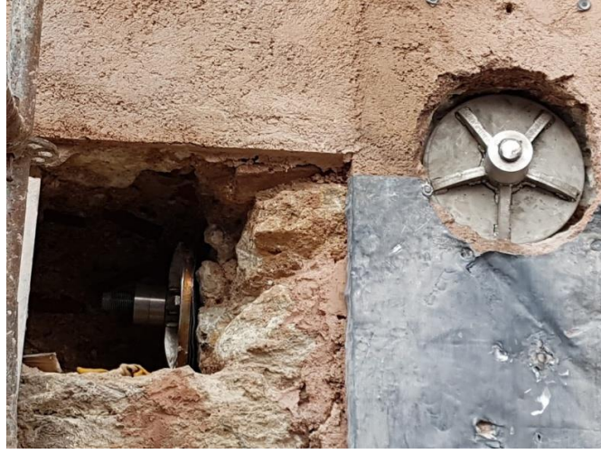
Şekil 4.2.4. İki yönde yapılan gergilerin durumu (Figure 4.2.4. The application of the tension rods in two orthogonal directions)
