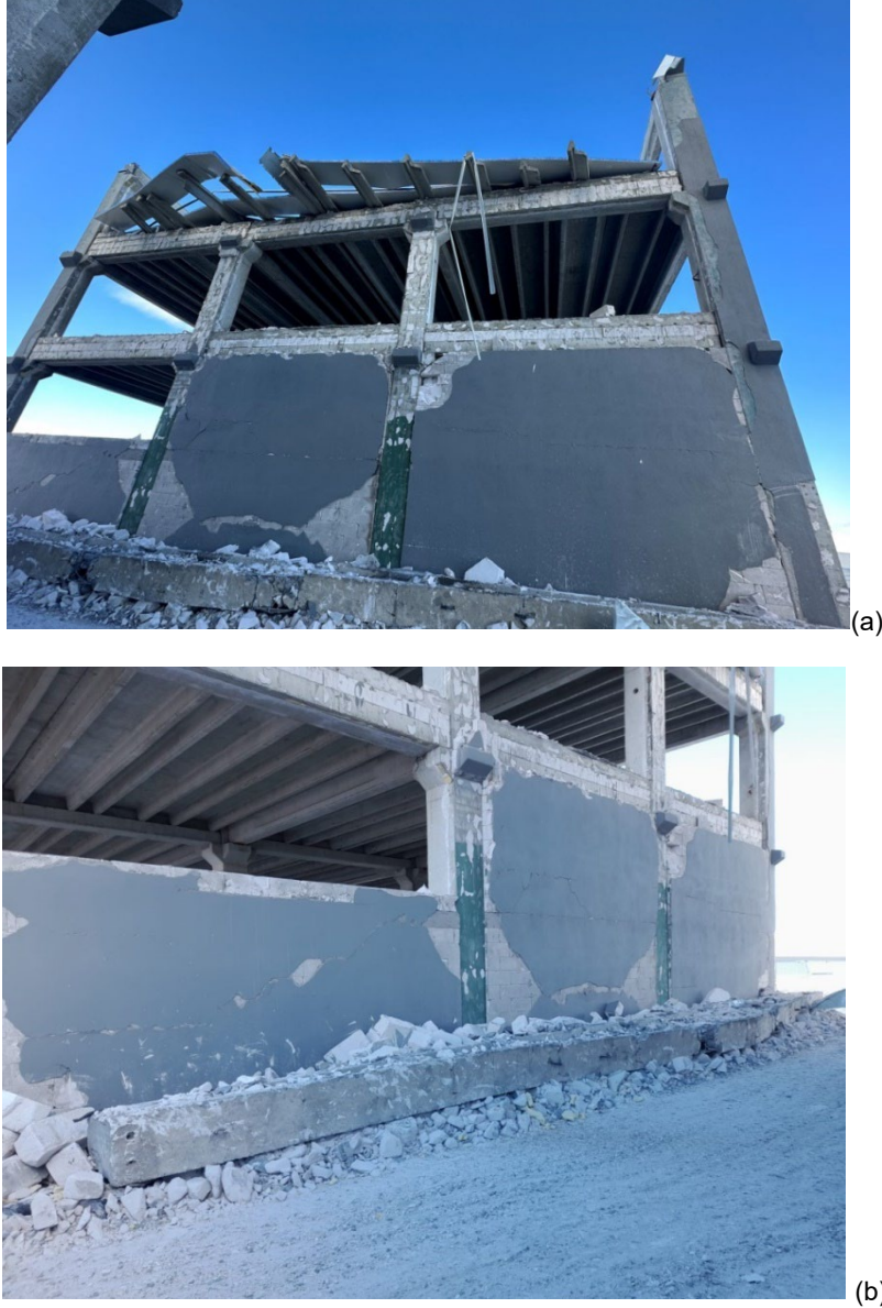
Şekil 8: Düzlem dışı devrilmiş makas kirişi Figure 8: Out-of-plane damage of precast beam
