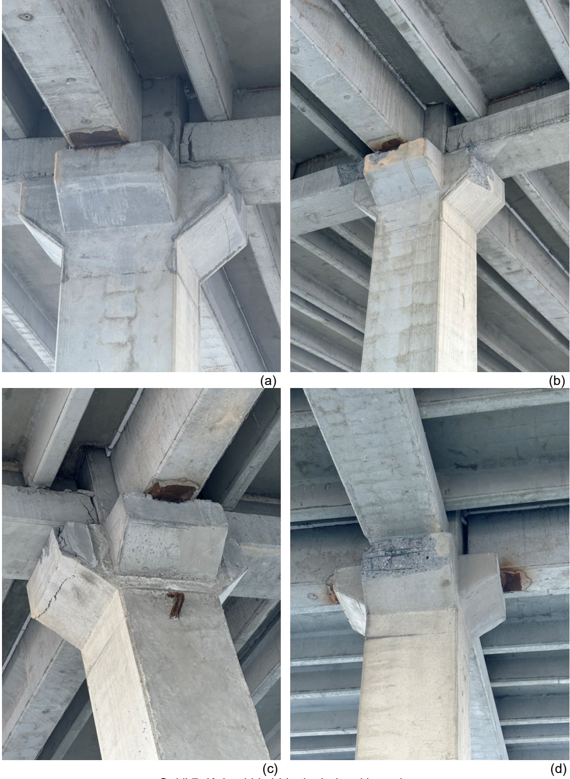
Şekil 7: Kolon kiriş birleşim bölgesi hasarları Figure 7: Column beam connection damages
