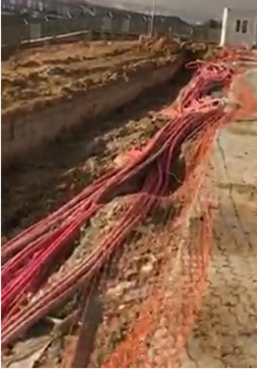
Şekil 1. Aynı galeri içerisinde bulunan çok sayıda orta gerilim yeraltı kablosu
