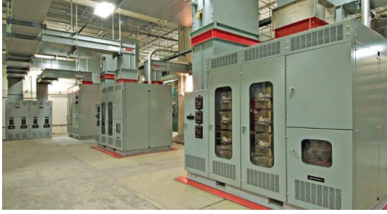
Şekil 10. Trafo Odası, Washington DC/ABD (c3mpowersystems.com, 2019)
