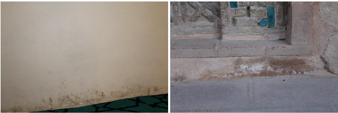
Fotoğraf 12. İç ve dış mekan duvarlarında tuzlanma – çiçeklenme
