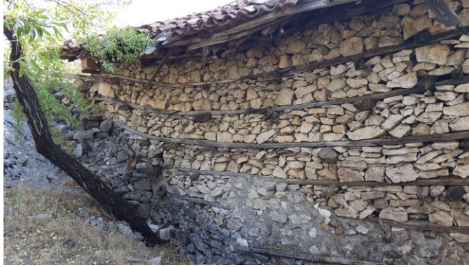
Şekil 21. Yapının doğu cephesinde görülen deformasyonlar.
