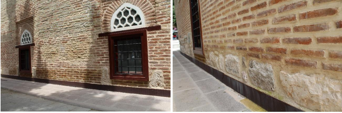
Fotoğraf 10. Kuzey cephe duvar yüzeyinde oluşan nem ve rutubet.
