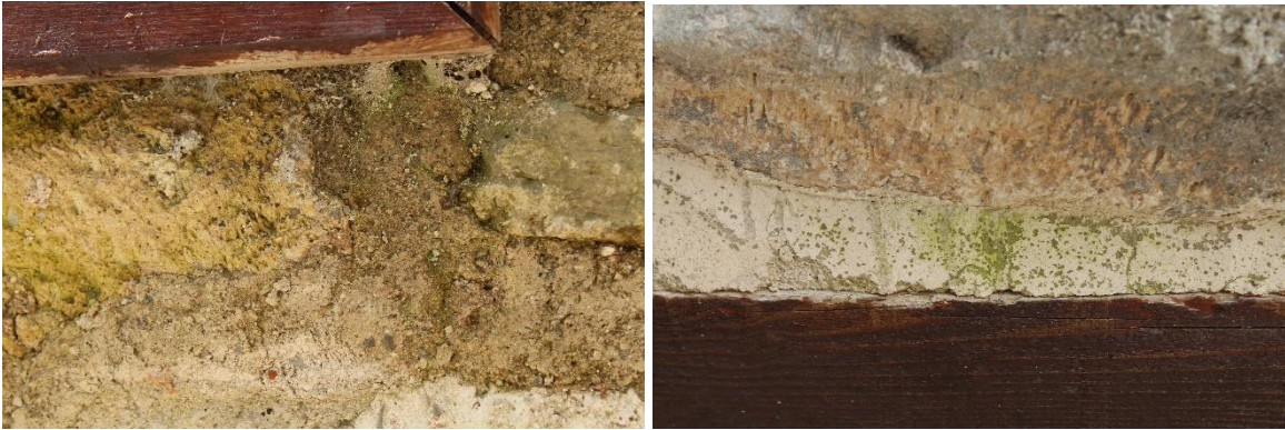
Fotoğraf 11. Kuzey cephe duvar yüzeyinde oluşan nem ve rutubet.
