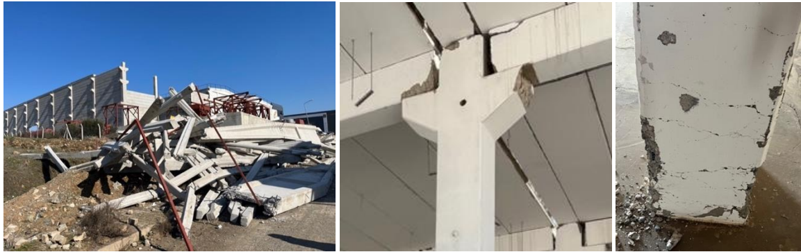
Şekil 3. Geçmiş depremlerde gözlemlenen sanayi fabrikalarındaki yapısal hasarlara örnekler: çökmüş fabrika makasları ve çatıları (solda); kesme çatlağı ve pay pasları düşen kolon gusesi-makas birleşim noktası (orta); ve mafsallaşma göstermiş 2000 yılı öncesi bir prekast betonarme kolon (sağda).
