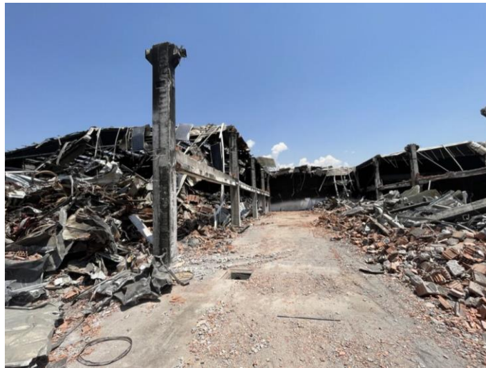
Şekil 4. Bir prekast betonarme sanayi tesisinde deprem sonrası yangın hasarı örneği
