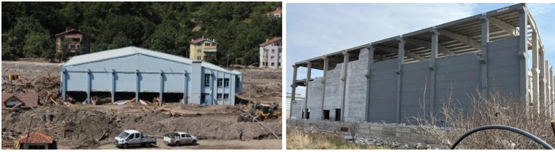
Şekil 6. Geçmiş afetlerde görülen yapısal olmayan dış cephe çökmelerine örnekler: sel hasarları (sol); kaynak: İstanbul Üniversitesi-Cerrahpaşa, 2021) ve deprem hasarları (sağ).
