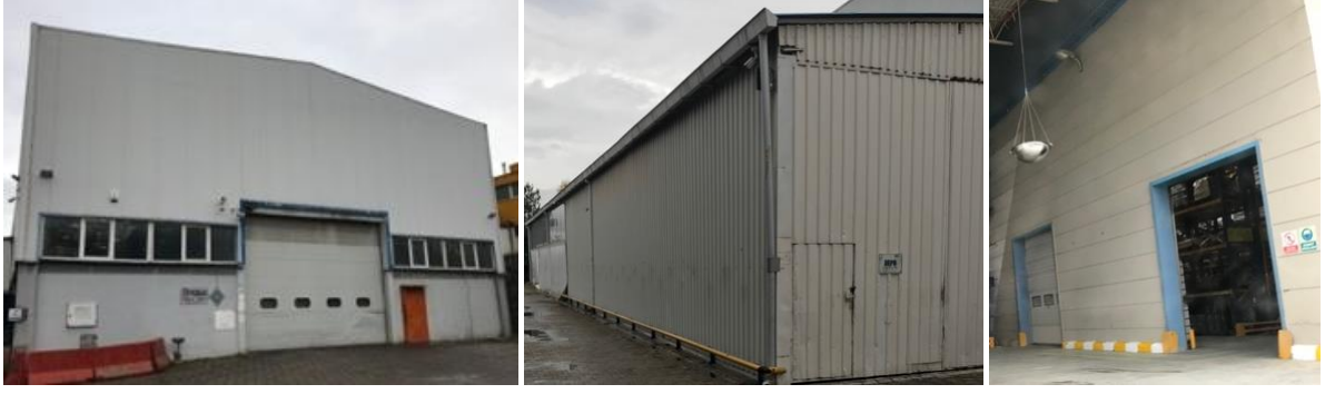
Şekil 5. İstanbul ve Kocaeli'ndeki teknik geziler sırasında görülen yapısal olmayan dış cephe elemanları
