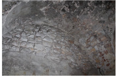
Fot.26: Maraş Kapalı Çarşı, Alacacıklar Arastası, güney bölüm örtü sisteminde özgün taş örgü
