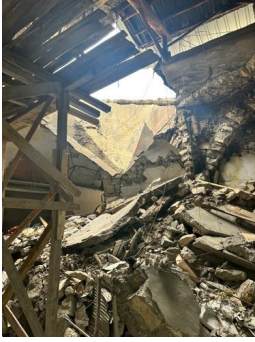
Fot.35: Maraş Kapalı Çarşı, 6 Şubat 2023 depremi sonrası, Kavaflar Arastası 1773 ada 21-22 ve 23 parsellerde çöken dükkânlar (İ. Demirkol Bayrak)
