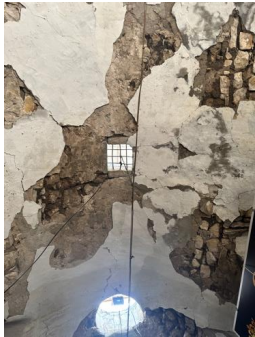
Fot.37: Maraş Kapalı Çarşı, 6 Şubat 2023 depremi sonrası tonoz hasar durumu (İ. Demirkol Bayrak)
