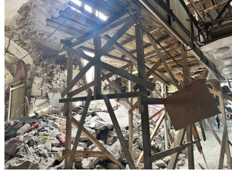
Fot.36: Maraş Kapalı Çarşı, 6 Şubat 2023 depremi sonrası, Kavaflar Arastası 1773 ada 21-22 ve 23 parsellerde çöken dükkânlar (İ. Demirkol Bayrak)
