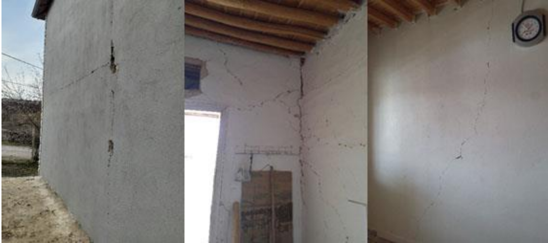
Şekil 11. Yığma yapılarda A tipi hafif hasar örneği Çayırköy Mahallesi (İnş. Müh. Kadir Bostancı Arşivi)
