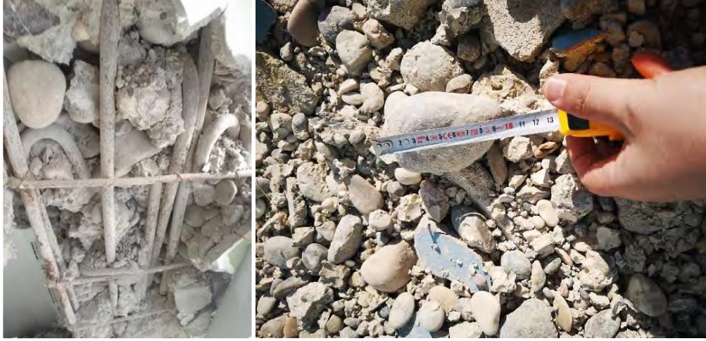
Şekil 7. 6 Şubat 2023 Maraş depremlerinde düşük beton kalitesinden kaynaklı meydana gelen hasarlar (Düzce Üniversitesi ve diğerleri, 2023, s.71)
