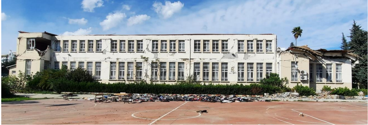
Şekil 8. Yıkılmayan birimdeki kısa kolon durumundaki düşey hatıllardaki hasarlar
