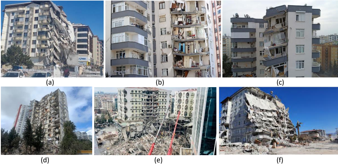
Şekil 15. 6 Şubat 2023 Kahramanmaraş depremlerinden sonra deprem bölgelerinde yapının bir kısmının dikey yönde çökmesini gösterir görseller (a) Malatya’da döşeme süreksizliği nedeniyle ağır hasar alan yapı
