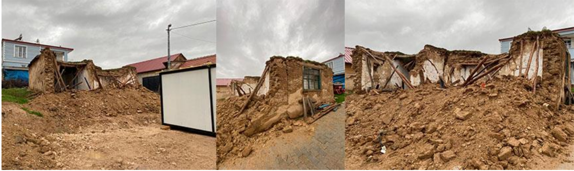
Şekil 16. Yığma yapılarda D tipi çok ağır hasar örneği Çayırköy Mahallesi (İnş. Müh. Kadir Bostancı Arşivi)
