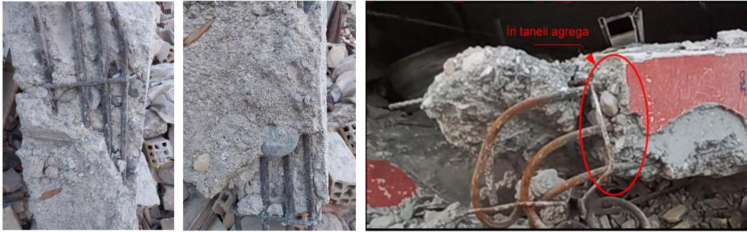
Şekil 8. Kahramanmaraş ve Hatay’da göçen bina betonunda bulunan iri malzeme kaynaklı hasarlar (MSKÜ, 2023, s.56)
