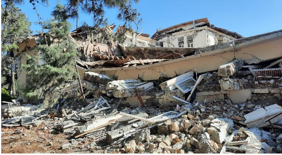
Şekil 7. Yıkılan birimdeki kısa kolon durumundaki düşey hatıllardaki kırılma
