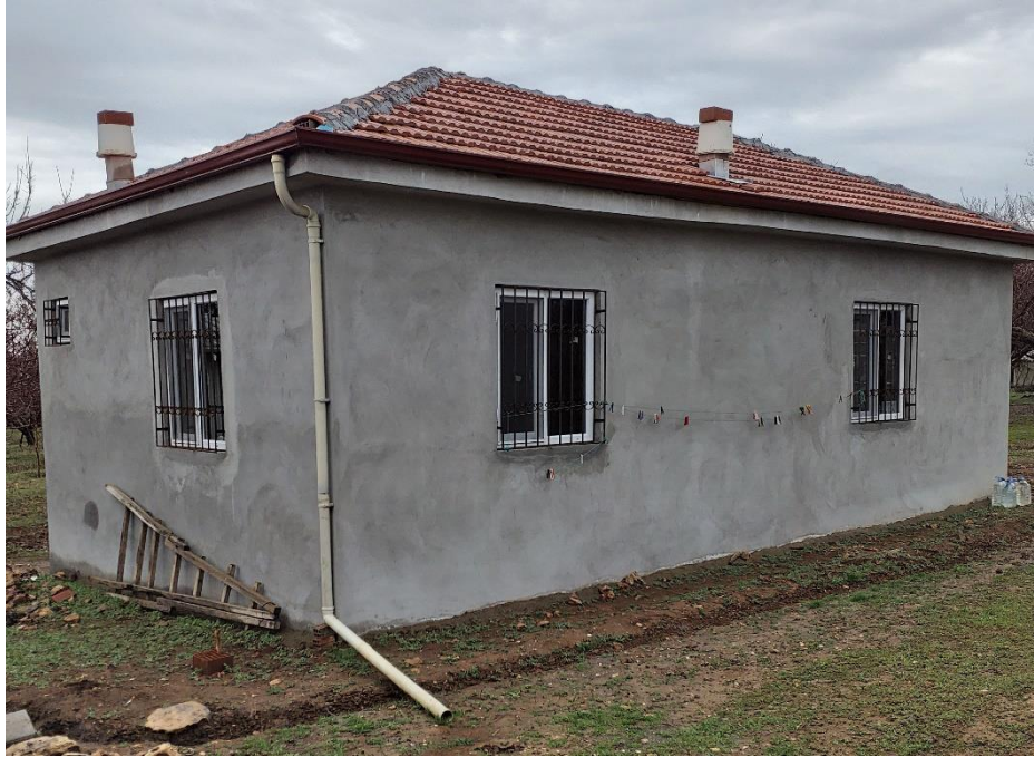
Şekil 9. Malatya İli Yeşilyurt İlçesi Çayırköy Mahallesi hasarsız bina örneği (İnş. Müh. Kadir Bostancı Arşivi)
