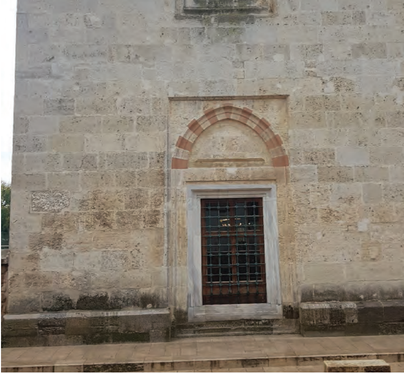
G. 9: Hünkâr mahfil-i giriş kapısı olarak kullanılan pencere ve üzerindeki saçak izi (N. Ç. Akçıl Harmankaya, 2022)
