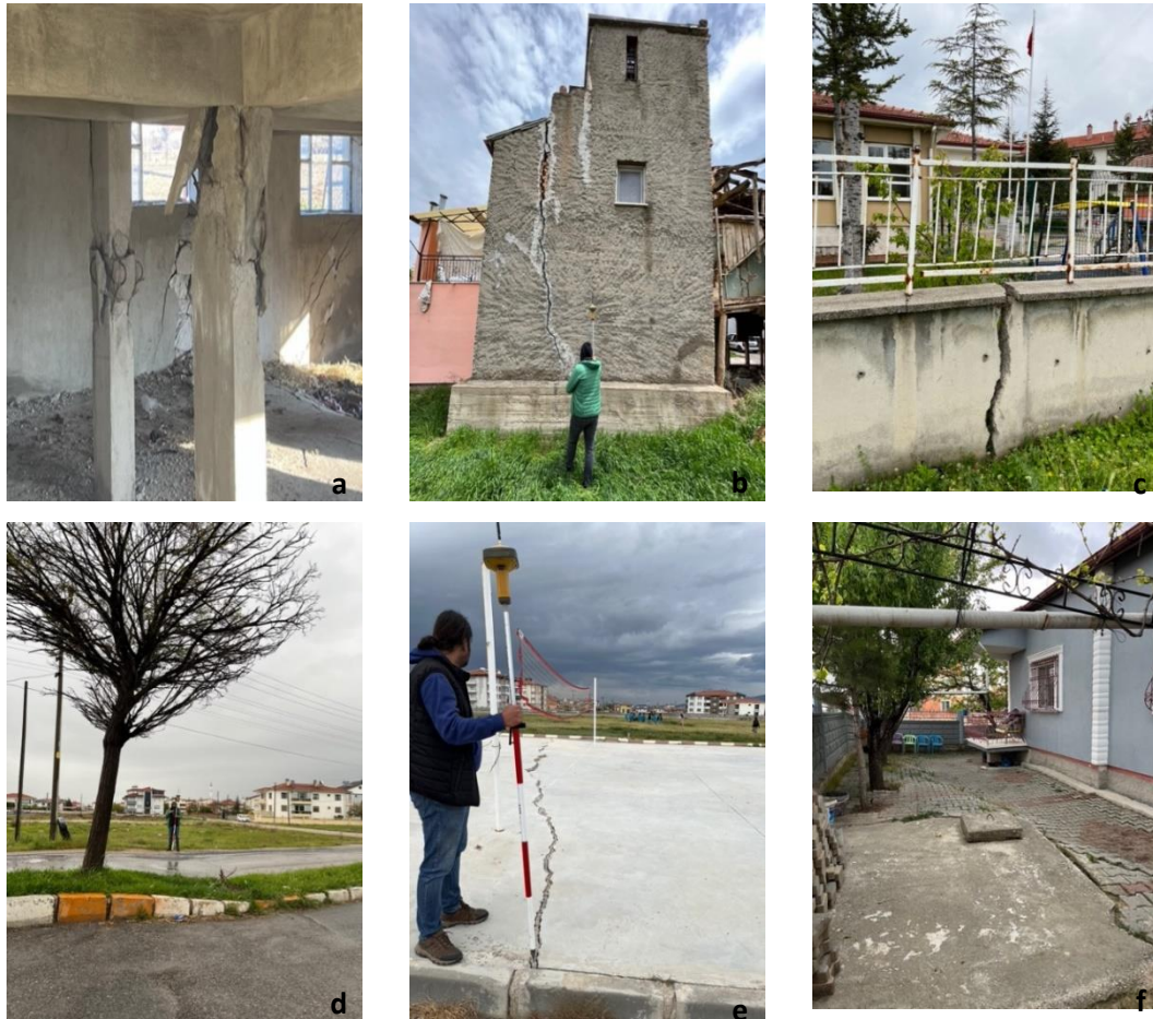
Şekil 11. Asismik yüze deformasyonlarının meydana getirdiği hasarlar, a) Betonarme yapı hasarları, b) Yığma yapı hasarları, c) Çevre duvarı hasarları, d) Yol hasarları, e) Kamusal yapı hasarları, f) Bahçe hasarları
