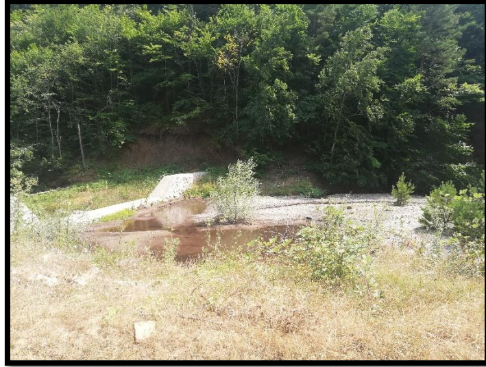
Fotoğraf 3. 1129 m Rakımdaki Gölün Sediman Dolumunu Engellemek İçin Yapılan Set Tamamen Sediman ile Dolmuş ve Kapanmıştır (2023).
