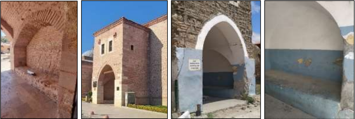
Şekil 39: Restore Edilen Yapının Eyvanlı Giriş Alanındaki Niş Kısımını ile Özgün Taş Kaplaması ve Restore Edilmeden Önce Yapının Eyvanlı Giriş Alanındaki Niş Kısımını ve Boya Tabakası 102
