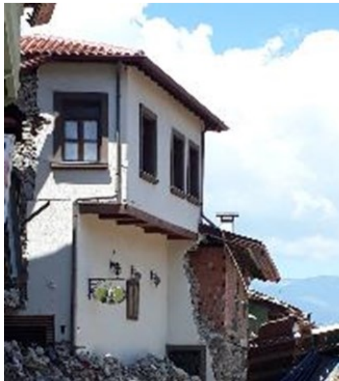
Resim 13. Onarım ve yeniden işlevlendirme sırasında içeriden eklenen tuğla duvar nedeniyle özgün duvarın zayıflaması (Yazar arşivi)
