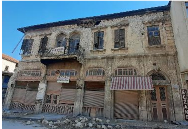
Resim 16-17. Kesme taş kaplama malzemesinin altında ortaya çıkan kötü malzeme ve duvar işçiliği kalitesine örnekler (Yazar arşivi)
