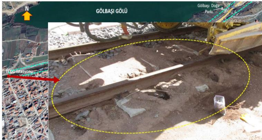
Şekil 12. Raylarda sıvılaşma Gölbaşı İstasyonu [11]
