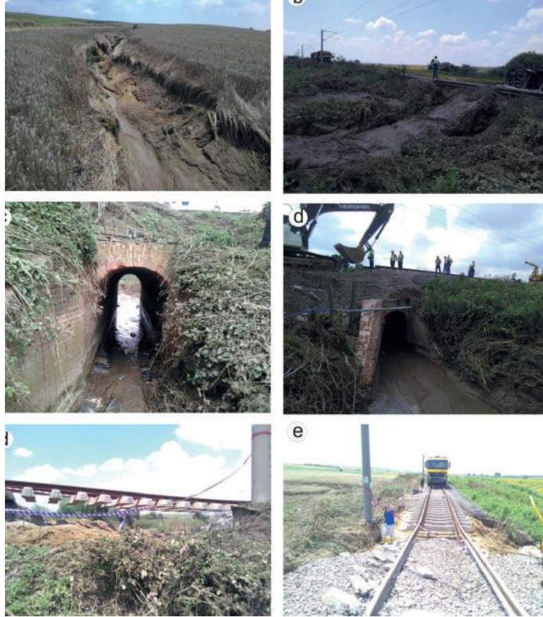
Şekil 19. Havza içerisinde gelişmiş sel yarıntısı (a), derenin getirdiği çamur malzemenin tren yolu menbası görünümü (b), tren yolu altındaki menfezin menba ve mansaptan görünümü (c menba, d mansap), askıda kalan raylar (d) ve onarılmaya başlanan rayların (e) görünümü [14]
