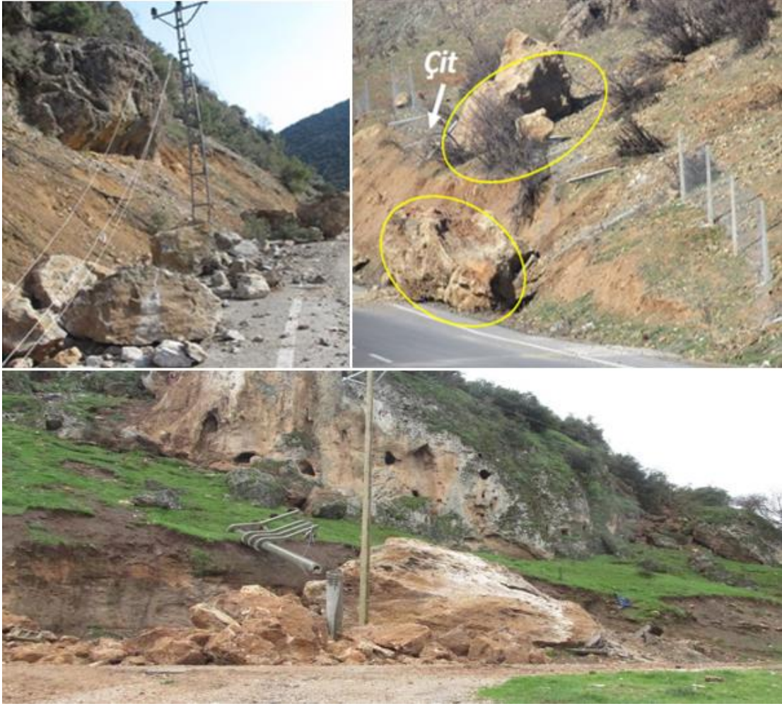
Şekil 17. Değirmencik, Tevekkeli ve Sakçağöz mevkieindeki kaya düşmeleri [11]
