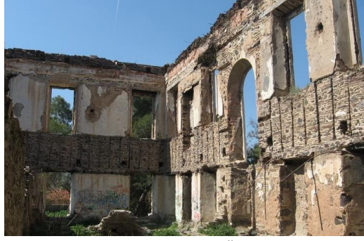
Foto 5. Yangın Sonrası - 2012 Restorasyonu Öncesi Durum (UDT İnşaat Arşivi)
