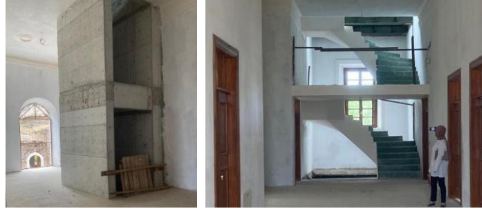
Foto 8. Yapıda katlar arası sirkülasyonu sağlamak amacıyla eklenen merdiven ve asansör boşluğu (Yazar Arşivi-2023 Eylül)
