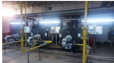
Şekil 1. İncelenen sıcak su kazanının bulunduğu kazan dairesi görüntüsü (En sağdaki incelenen kazan)
