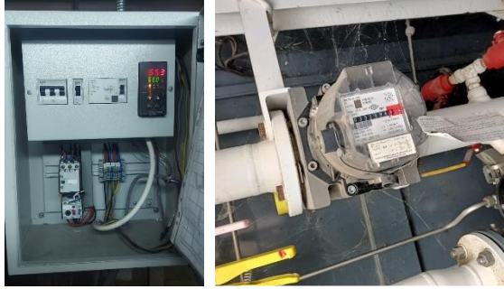
Şekil 3. Sıcak su kazanının kumanda panosu ve doğalgaz sayacı
