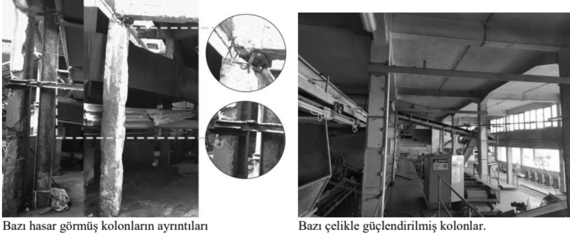
Şekil 12. Hasar görmüş kolon ve güçlendirilmiş kolon örnekleri, Arhavi Çay Fabrikası (Yazar Arşivi, 2022).
