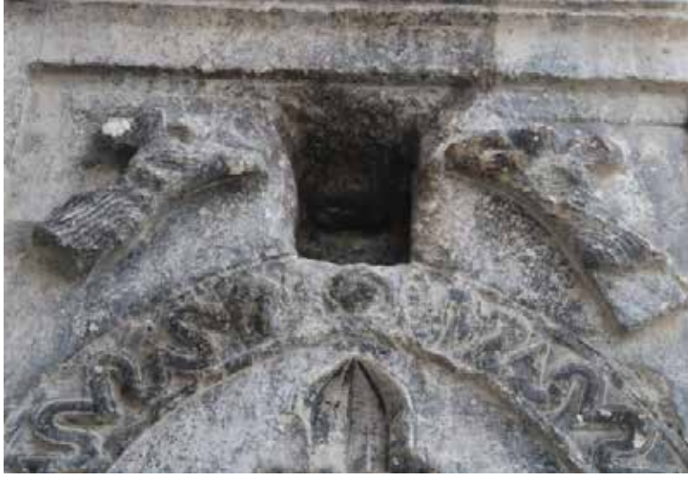
Görsel 10. Susuz Han güney yan niş köşeliklerinde yer alan melek figürleri, altta yer alan ejderler ve daire formundan ayrıntı.
