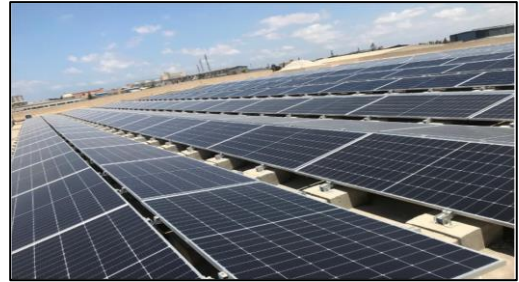
Şekil 6. Fabrikada yer alan çatı üstü PV sisteminin görüntüsü (Image of the rooftop PV system in the factory)
