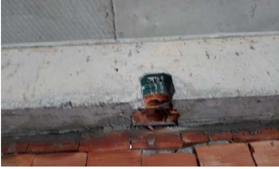
Şekil 2. Kiriş İçinde Yanlış Buat Yerleşimi
