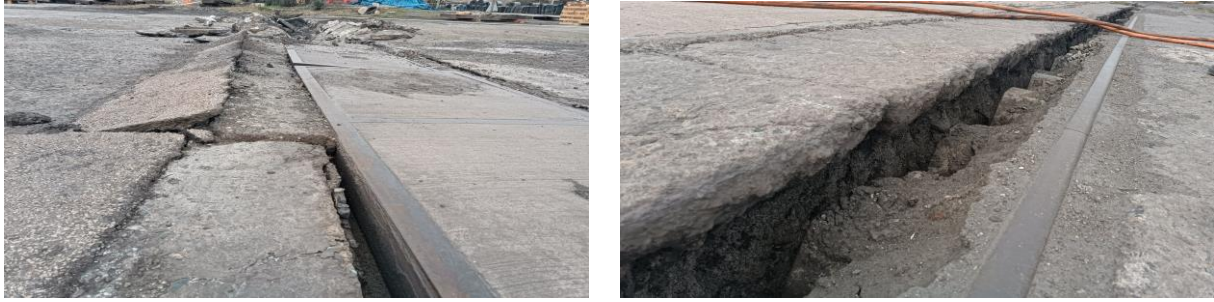
Şekil 2. Saha hasarı – kırılma
