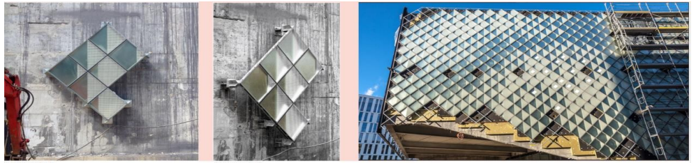
Şekil 18. Braketlerle betona üzerine ankrajlanmış cam paneller ile alüminyum profillere camların yerleştirilmesi ( https://www.arup.com/news-and-events/modularization-meets-variability-futurium-showcases-curtain-walling-of-tomorrow )
