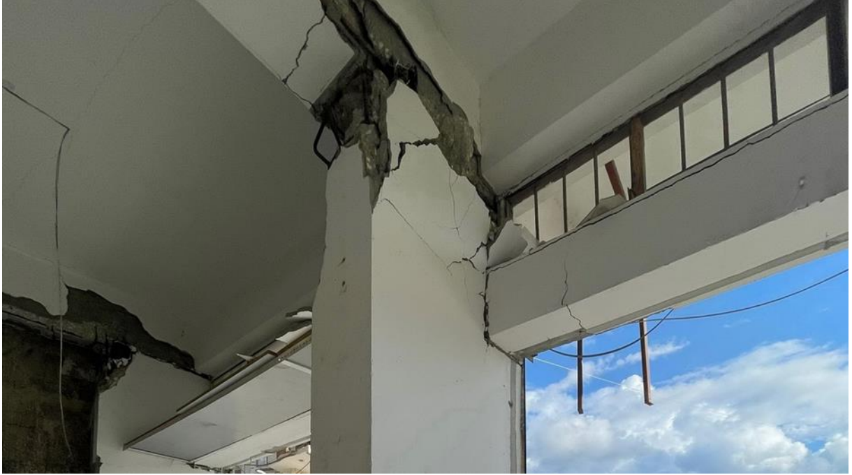
Resim 2. Kısa kolon etkisi (iki bant pencere arasında kalan kısa kolonda deprem sonrası oluşan zarar)
