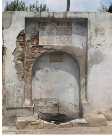
Şekil 1. Hacı Ali Ağa Cami Çeşmesi'nin onarım öncesi hali (Özbalkan, 2019)
