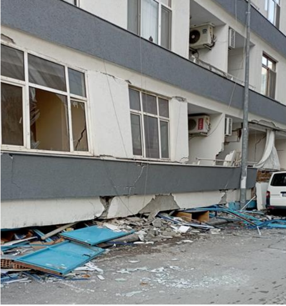
Resim1. Antakya'da yumuşak kat durumu: Deprem sonrası yok olmuş zemin katlar
