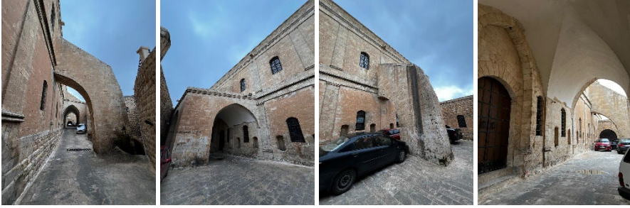
Şekil 18. Eski Askeri Kışla'da yaşanan zemin kayması sonucu eklenen payandalar (Yazarlar arşivi, 2024)
