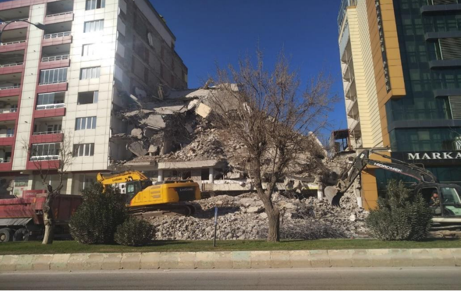
Fotoğraf 2. Kahramanmaraş kent merkezinde devam eden ağır hasarlı binaların yıkımı ve yerinde ayrıştırma ve kazanım çalışmalarından bir görünüm (28.02.2024 Tarihinde yazar tarafından çekilmiştir).
