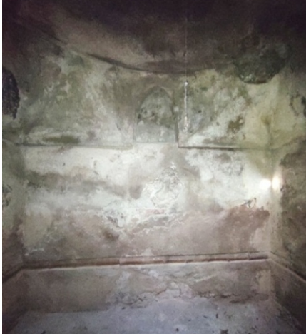
Şekil 19. Sıcaklık kuzey duvarı
