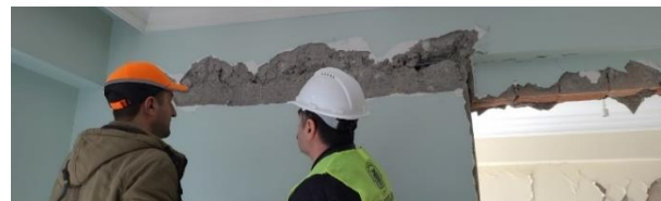
Şekil 6. Uygun olmayan perde tevzi, gövde donatısı detayı ve hatalı beton yerleşimi sonrası oluşan perde hasarı
