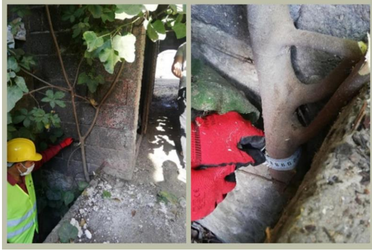
Şekil 24. Bodrum Katı İniş Merdivenlerinde Görülen Gövdesi 17 cm Çapındaki Ağaç.
