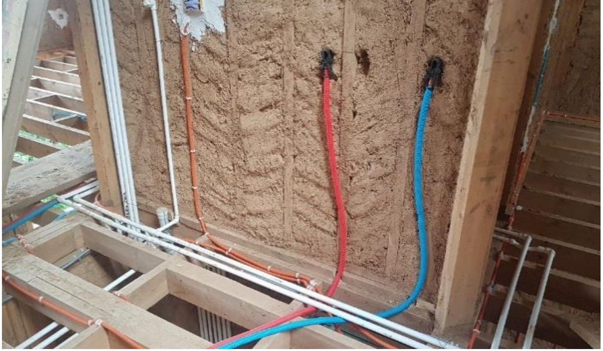
Şekil 11. Döşemeden ve duvardan geçen tesisat boruları
