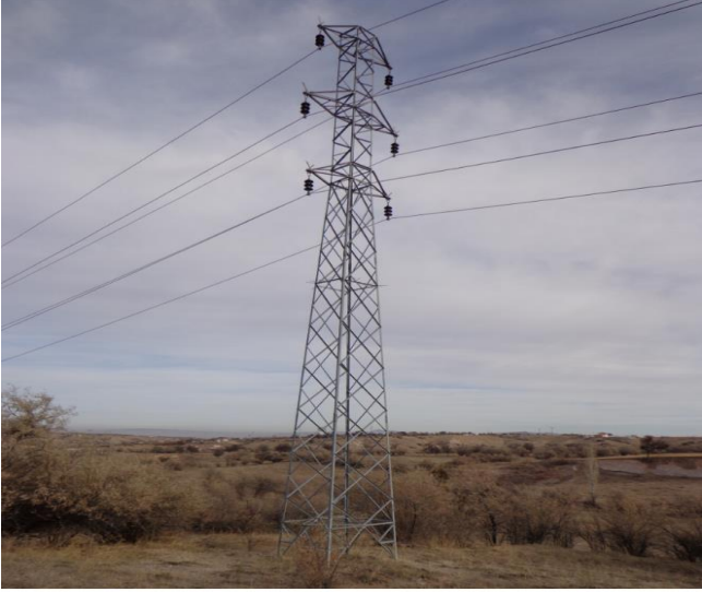
Şekil 1. Enerji nakil hattı
