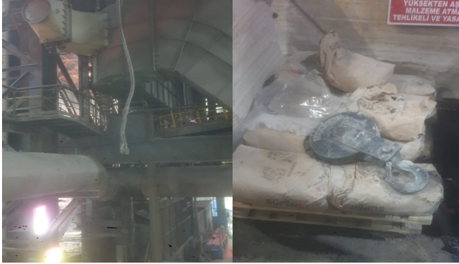
Şekil 4. Switch arıza yapmış ve kanca düşmüş
