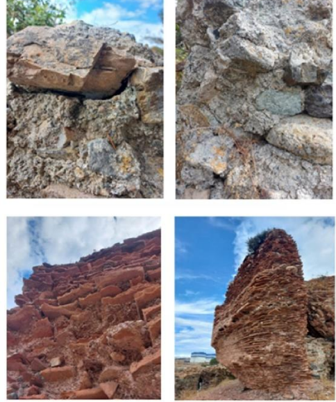
Resim 8: Sur kalıntılarında tespit edilen harç bozulmaları ve yapı malzemesi olarak kullanılan tuğlalarda gözlemlenen bozulmalar
