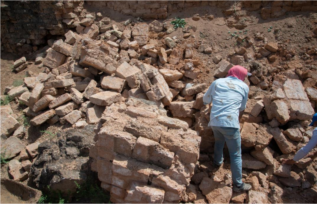
Fig. 5: 6 Şubat depremleri sonrasında yıkılan VII. Tabaka Sarayı'nın kerpiç doğu duvarı (Fotoğraf M. Akar).
