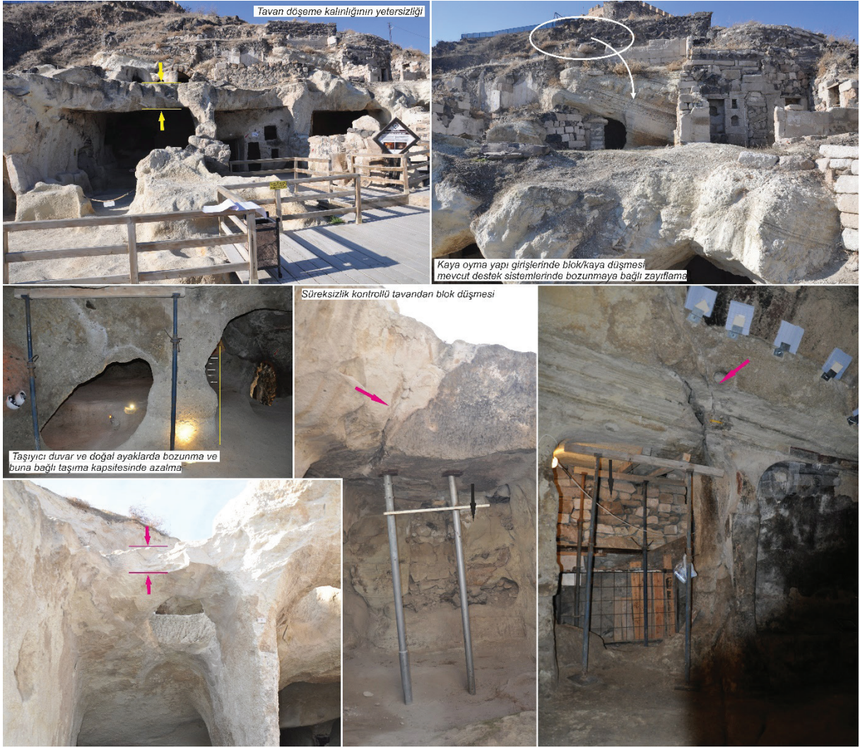
Şekil 16. Kayaşehir’de kaya oyma yapılarda gözlenen stabilite problemlerine ait fotoğraflar.
