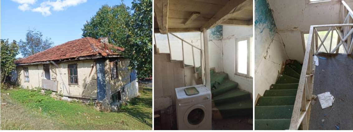
Görsel 27. Yapının terk edilmesi sonucunda ciddi derecede yapı içerisinde ve dışında çatlaklar, malzeme kayıpları gibi sorunların oluşması
