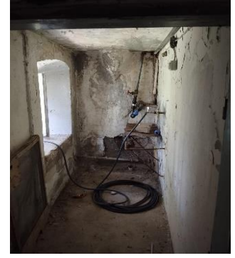
Şekil 10d. Rutubetin Duvar Yüzeyine Etkisi
