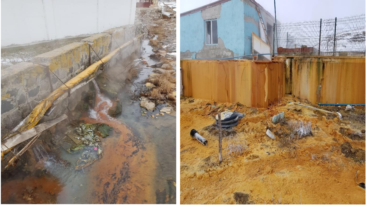
Şekil 2. Jeotermal Suyun Hasar Oluşturduğu Yapılar
