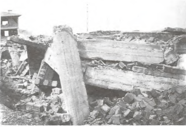
Şekil 19 Erzincan güncybatısındaki bir kooperatife tamamiyle yıkılmış çok katlı bina. Burada da görüleceği gibi ilk hasar gören kısım kolon kiriş bağlantılarıdır. Yapılar genellikle güneye doğru yıkılmıştır.
