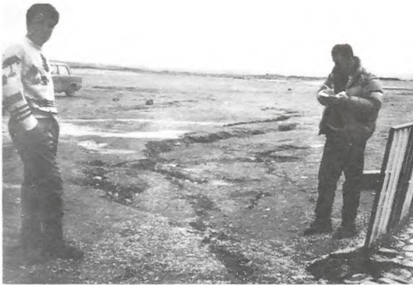
Şekil 11 Ekşisu Madensuyu tesislerinin yanındaki suni dolgu zeminde gelişen oturma yapıları ile ilgili yarıklar (çekim kuzeybatıdan güneydoğuya).
