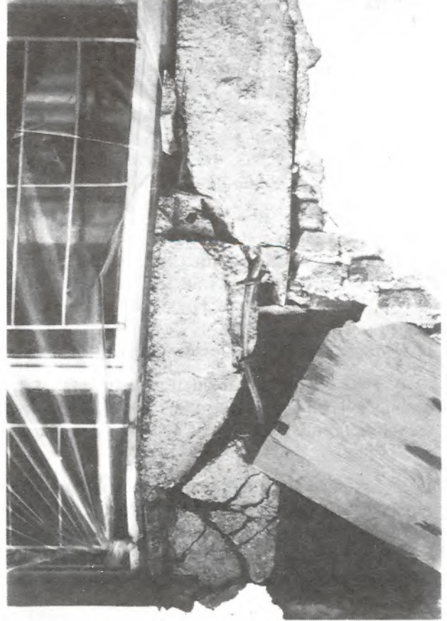
Şekil 21 Erzincan şehir merkezinde hasar görmüş çok katlı bir binanın kolonuna ait demirdeki deformasyon ve betondaki makaslaşma çatlakları (çekim güneyden kuzeye).
