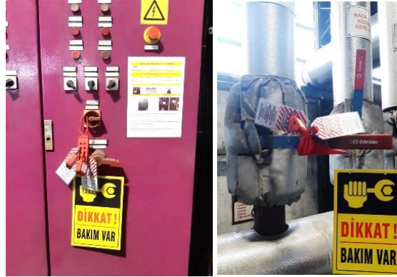
Şekil 8. Kızgın Su Kazanında Yıllık Periyodik Bakım Çalışması Sırasında EKED Uygulaması (LOTOTO Application during the Annual Periodic Maintenance Study in the Hot Water Boiler)
