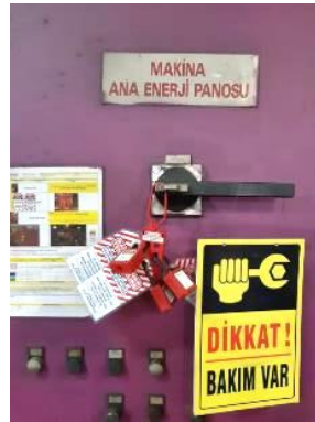
Şekil 6. Askılı Temizleme/Kumlama Makinesinde Helezon Değişimi Çalışması Sırasında EKED Uygulaması (LOTOTO Application During the Screw Change Study in the Suspended Cleaning/Sandblasting Machine)
