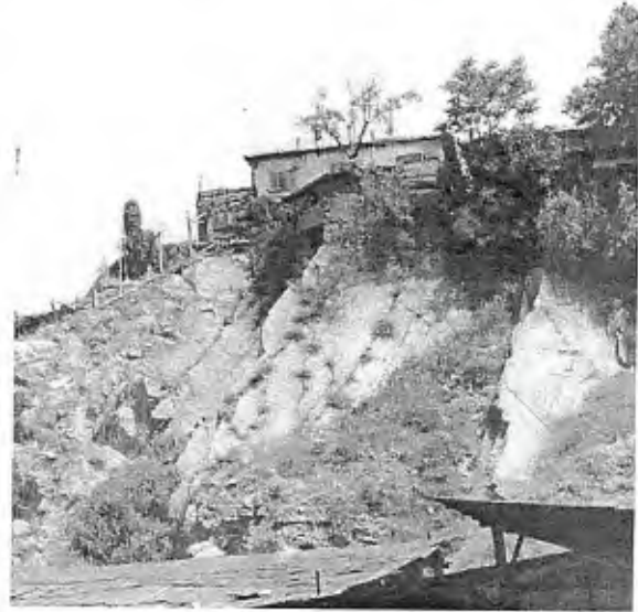
Şekil 10. Çalışma alanındaki güncel bir kama yenilmesi.
