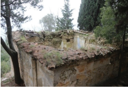
Şekil 40. Yıkılmış türbe çatısı (2023)
