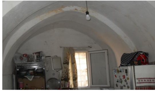
Resim 80. Çavuşin Köyü Ada 2 Parsel 6' daki Konutun Tavanı (Toruk, 2010)
