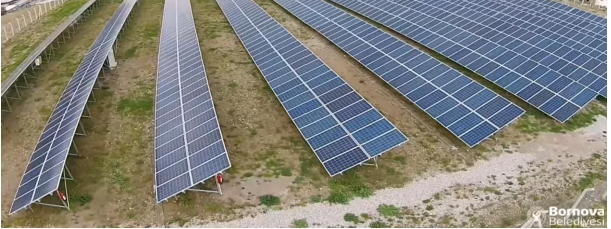
Görsel 2. Yenilenebilir enerji sistemi
