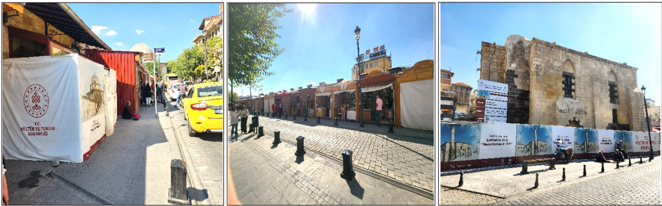
Fotoğraf 2: Deprem Sonrası Zarar Gören Zincirli Bedestenin ve Tahtani Caminin Son Hali (Restorasyon Çalışmaları-Mayıs 2024)
