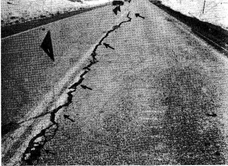
Sekil 19. Erzincan havzasına batı yönünden giresteki Sivas-Erzincan Karayolu'nun üzerinde gelişmiş oturma kırıkları. (D'ya bakıs)
