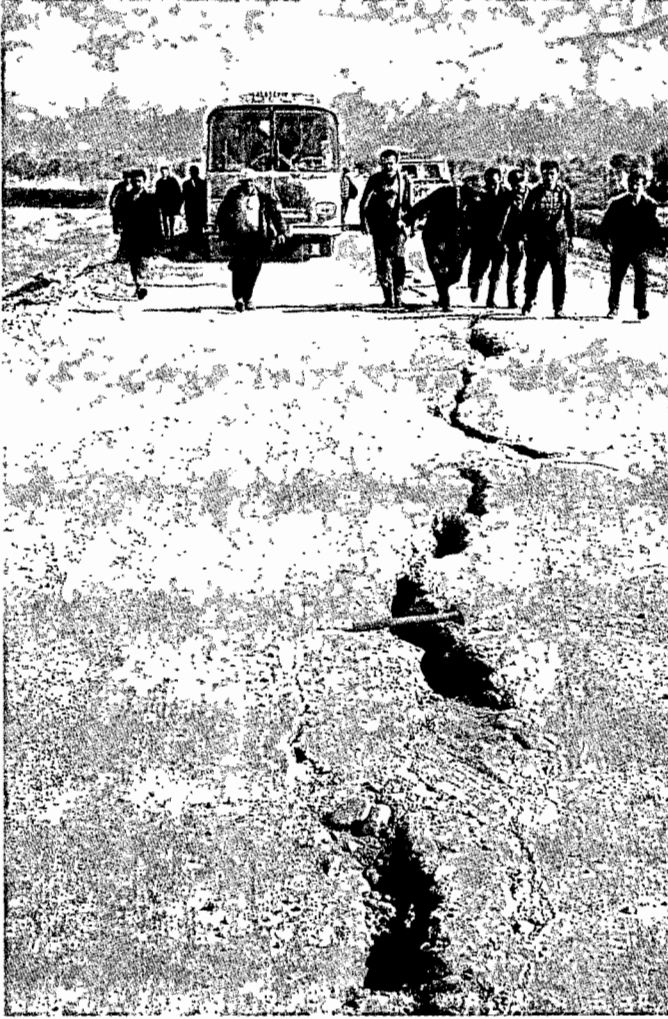
Foto 3. Kemaliye-Alaşehir yolu Baklacı köy köprüsü güney sahilinde K23D uzanlı kırık hattı açılma çatlakları.
