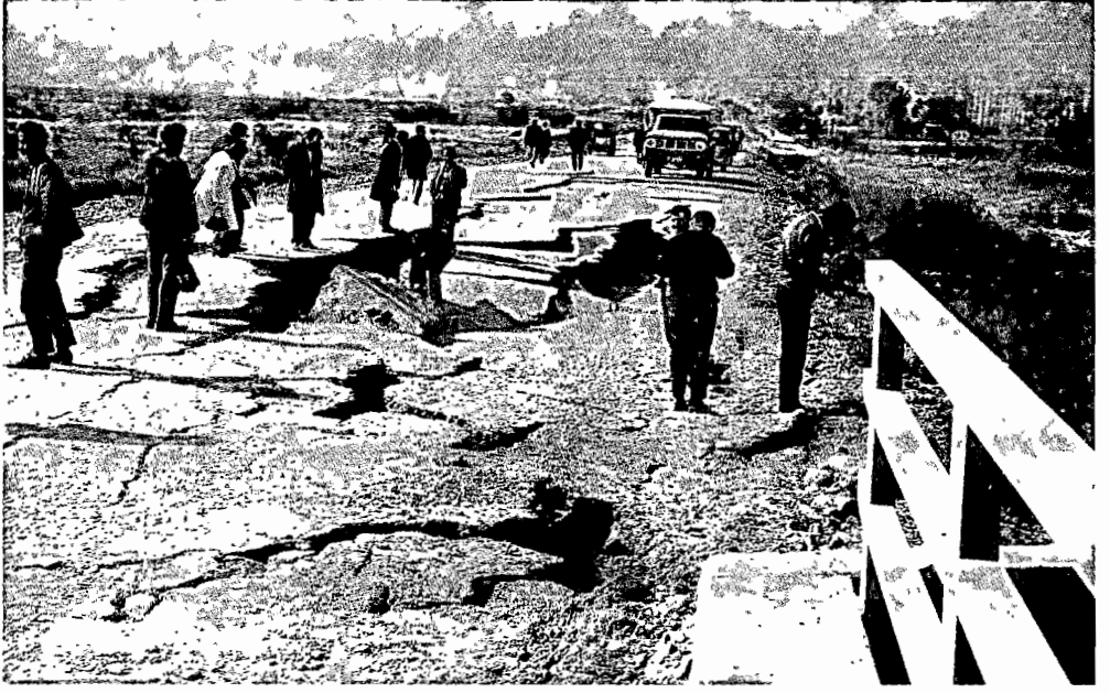
Foto. 4. Alaşehir-Kemaliye yolu Baklacı köprüsü güney sahili. Köprü ayağı yanında fay hattını ölçen Ergun Havur K80B uzanımlı Baklacı Piyadeler fay hattı görülüyor.
