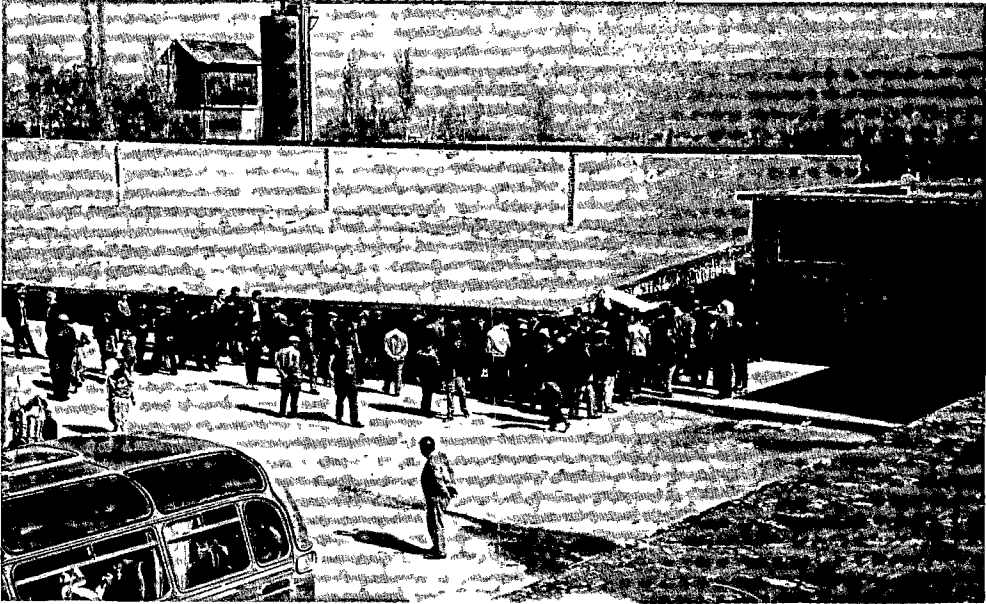
Foto 5, 6. Alaşehir otogar örtü betonu kiriş kolon bağlantısı zayıflığından bütün halinde çökmüş. Foto 12 de örtü betonu ile kuzey duvarı arasındaki açılmanın resmi. Otogar örtü betonu 2 m batıya doğru, 1 m' de güneye doğru ötelenmiştir. Foto 12 de altta kalan otobüsler görülüyor.
